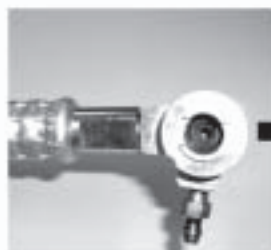
Foto 01 Com anel de vedação (errado)
